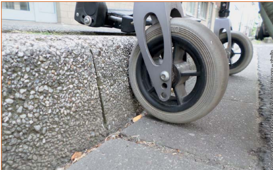
Ebene Wege sind nicht nur für Rollstuhlfahrer eine Erfordernis. Für einen großen Teil betagter aber nicht „behinderter“ Personen sind sie ebenso Grundvoraussetzung zur Selbstrettung.
